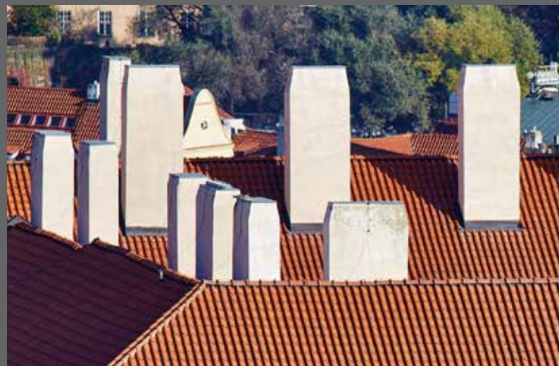
POZITIVNÍ PŘÍKLADY POVRCHOVÉ ÚPRAVY KOMÍNOVÝCH TĚLES
