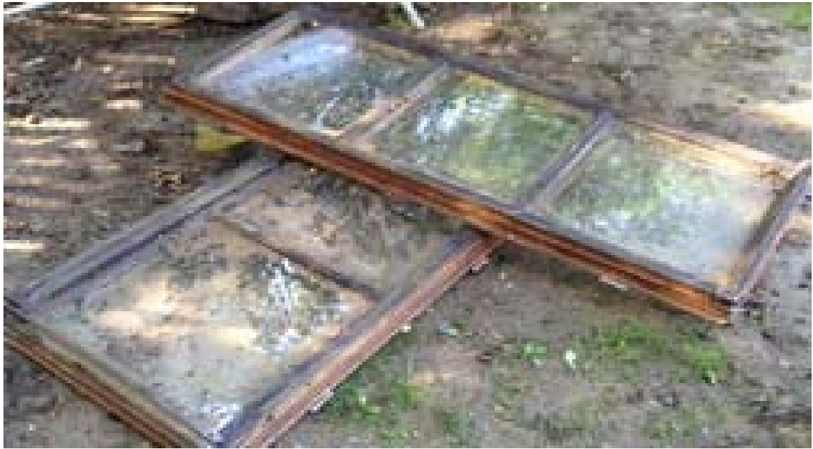
detail poškozených oken
