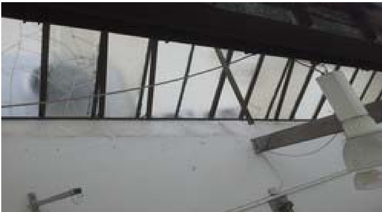
poškozený malý světlík
