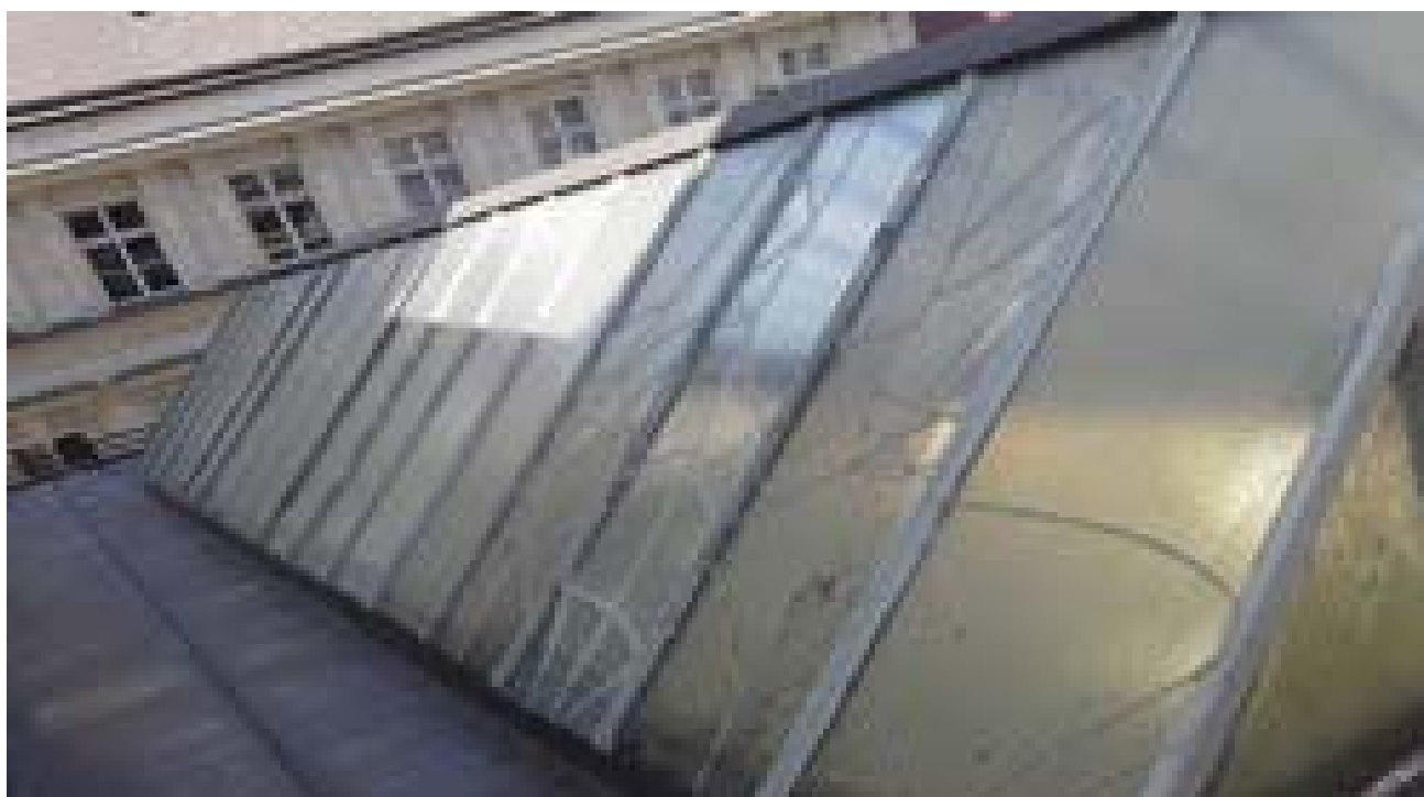
provizorní oprava světlíku (kovová konstrukce)
