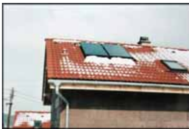
Obrázek č. 22 – Solární termické kolektory umístěné na střeše rodinného domu.
