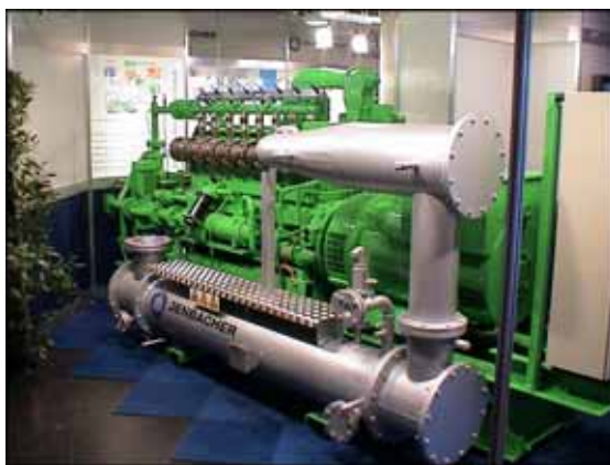
Obrázek č. 33 – Velká kogenerační jednotka.
