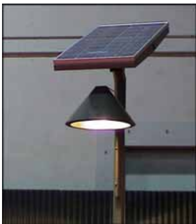
Obrázek č. 21 – Aplikace fotovoltaických panelů se lampou veřejného osvětlení.
