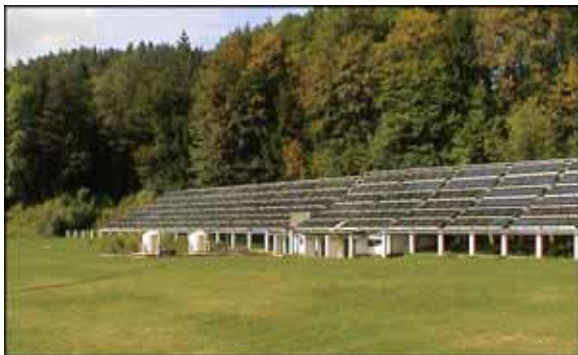
Obrázek č. 20 – Obří pole solární kolektorů k ohřevu vody v bazénu.
