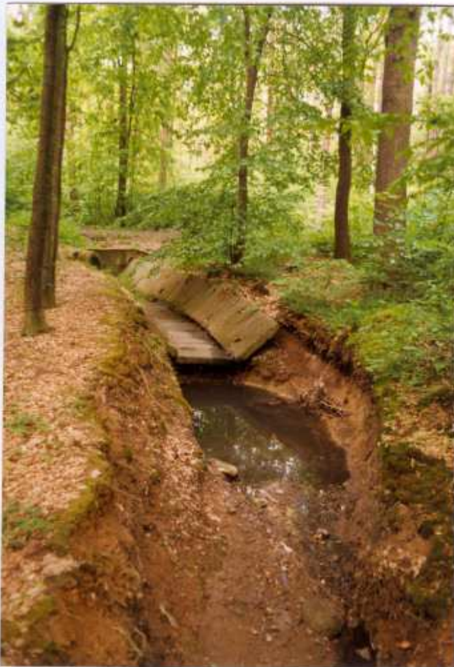
Vyústění kanalizace z Újezda v odd. 40 s výraznou erozí dna i boků koryta
