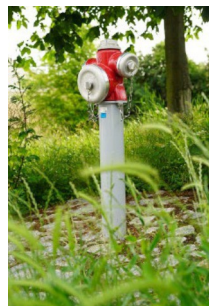
Hydrant, projekt Podzemní nádrže na dešťovou vodu v parku Královka, MČ Praha 6
