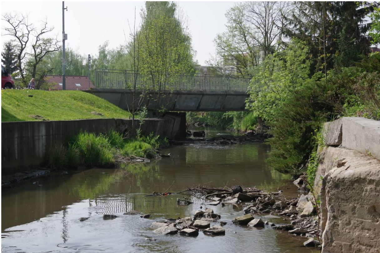
Hrouťící se břehové opevnění v Dubči pod silničním mostem
