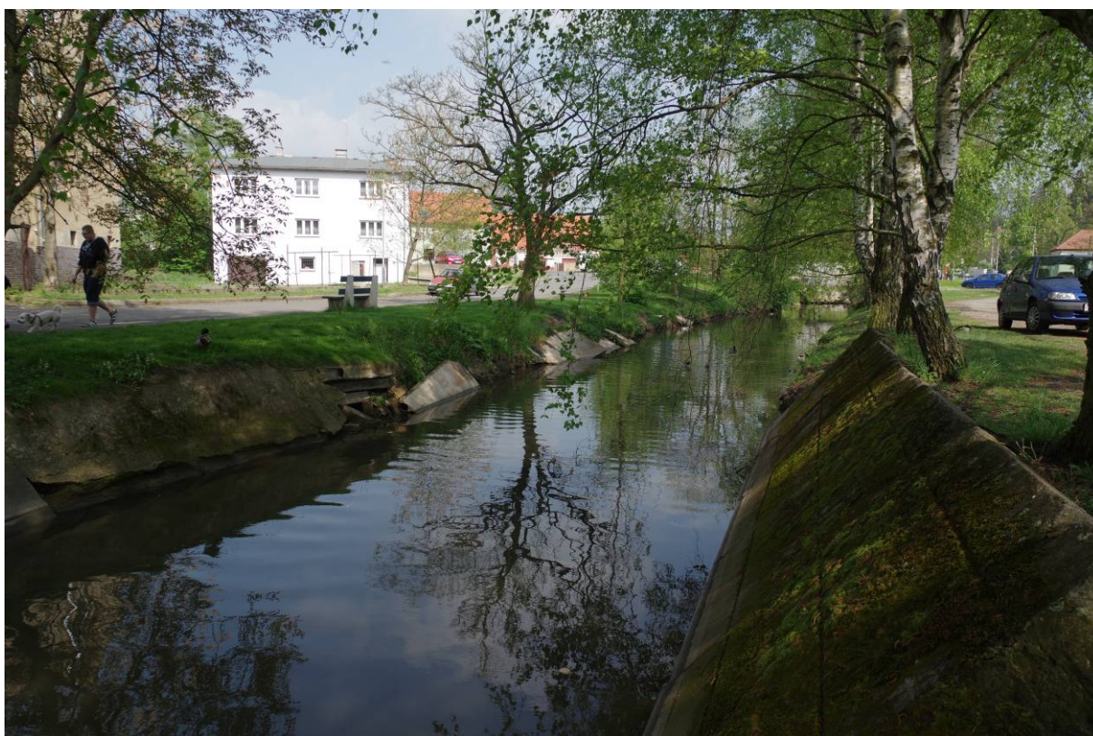
Poškozené břehové opevnění v Dubči
