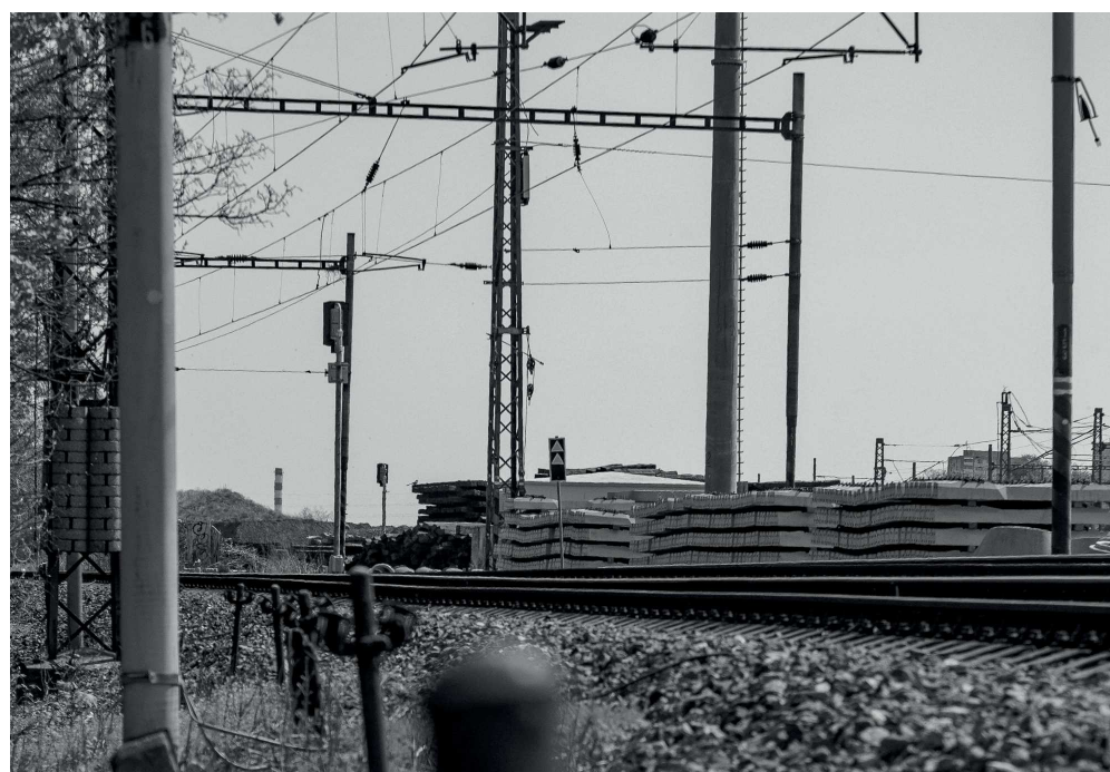
TRAKČNÍ VEDENÍ A BETONOVÉ PRAŽCE
